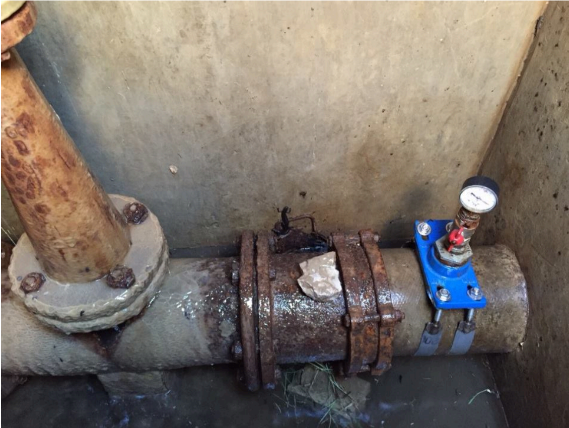
Figura 16: Manufatto di sezionamento e sfiato DN 200
