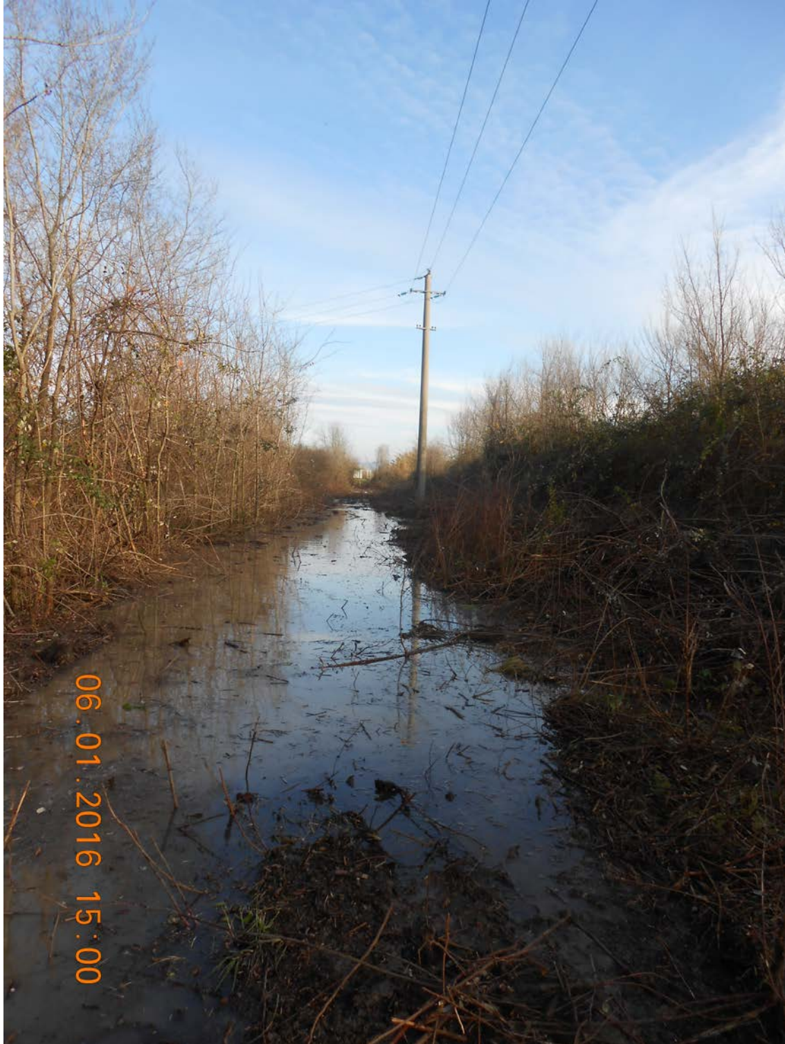
Figura 7: Perdite a seguito del caricamento del DN 550
