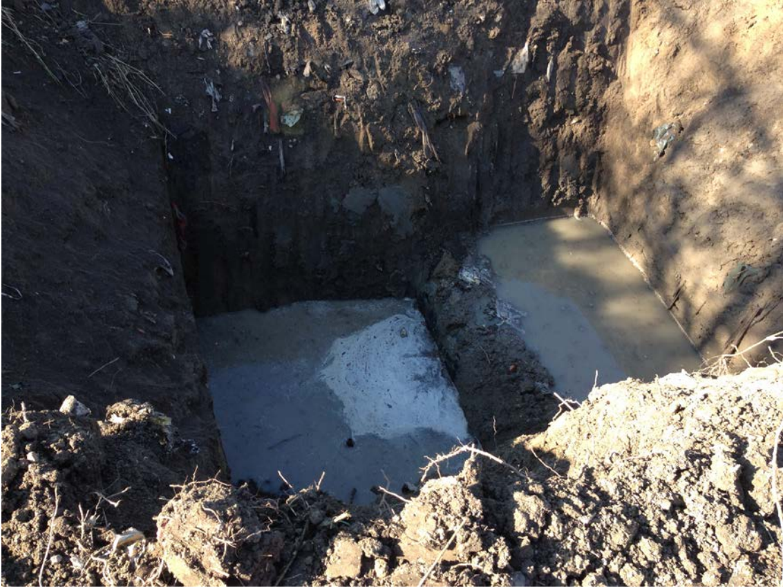
Figura 13: Saggio prog. Km 3.150
