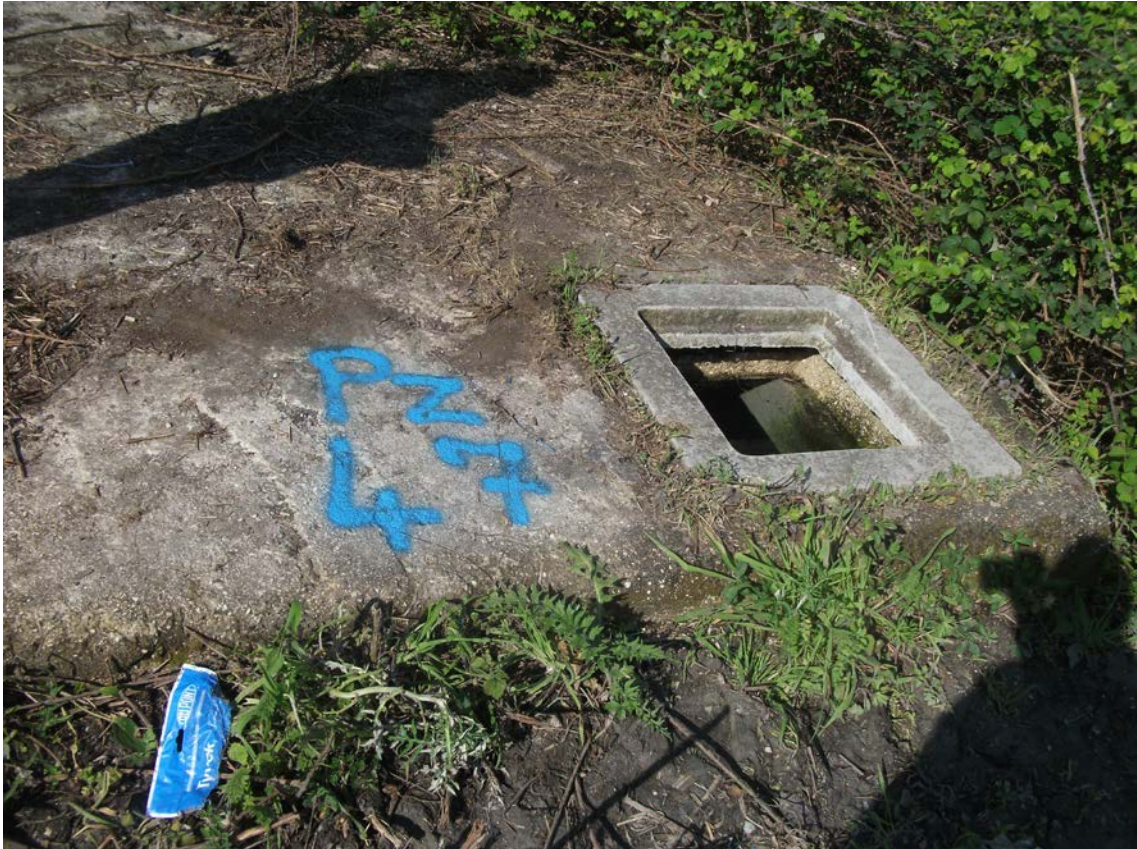
Figura 2: Ingresso pozzetto PZ/47
