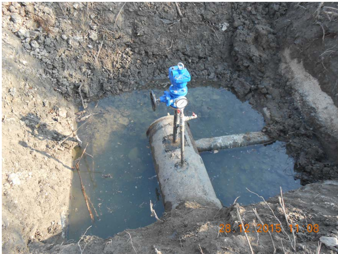
Figura 10: Messa in pressione del tratto di condotta da prog.Km 0.00 a prog Km 1.00
