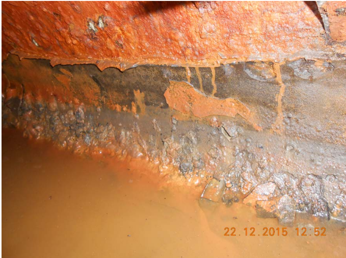
Figura 4: Stato di conservazione della condotta DN 550
