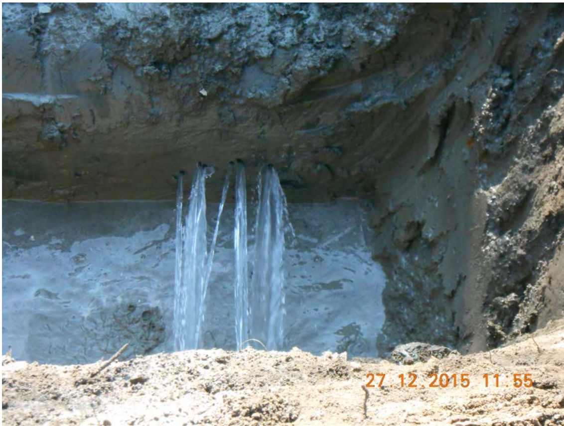
Figura 5: Prova di carico DN 550: particolare perdite
