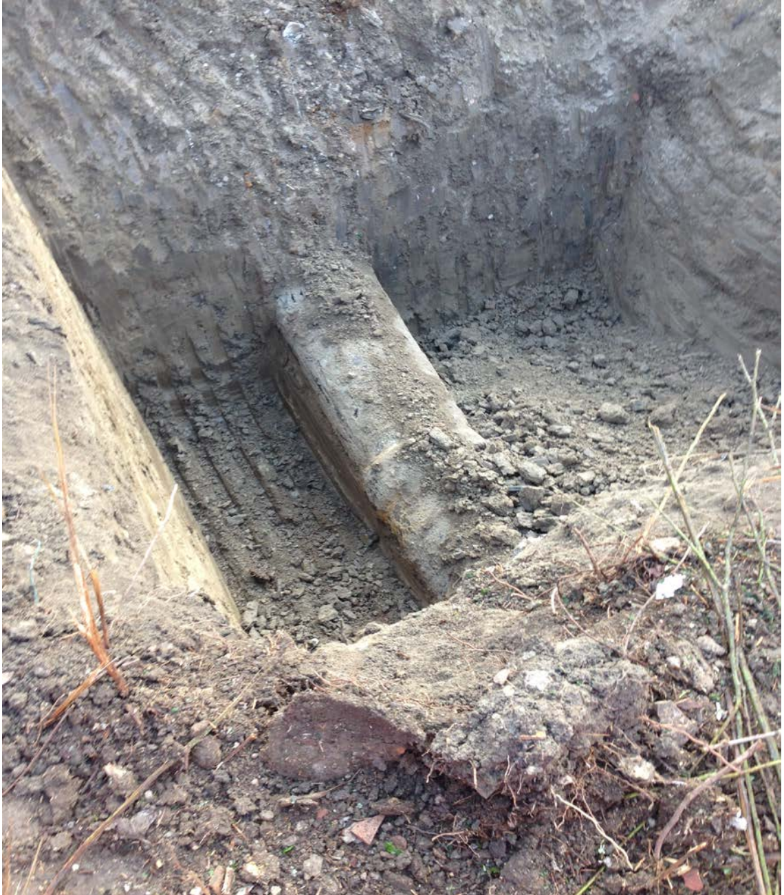
Figura 12: Saggio prog. Km 3.120
