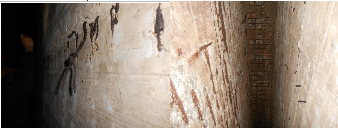
Evidenza dello stato di degrado delle pareti e della copertura
