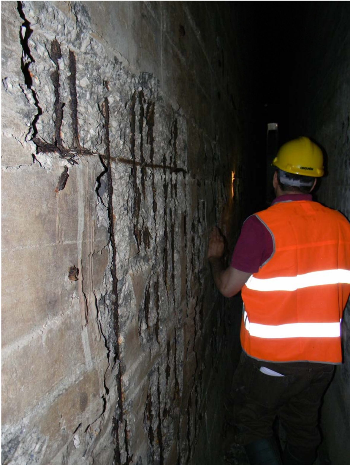
Foto 2 - Cunicoli – Esempio di tratto di parete con livello di degrado di livello “2”
