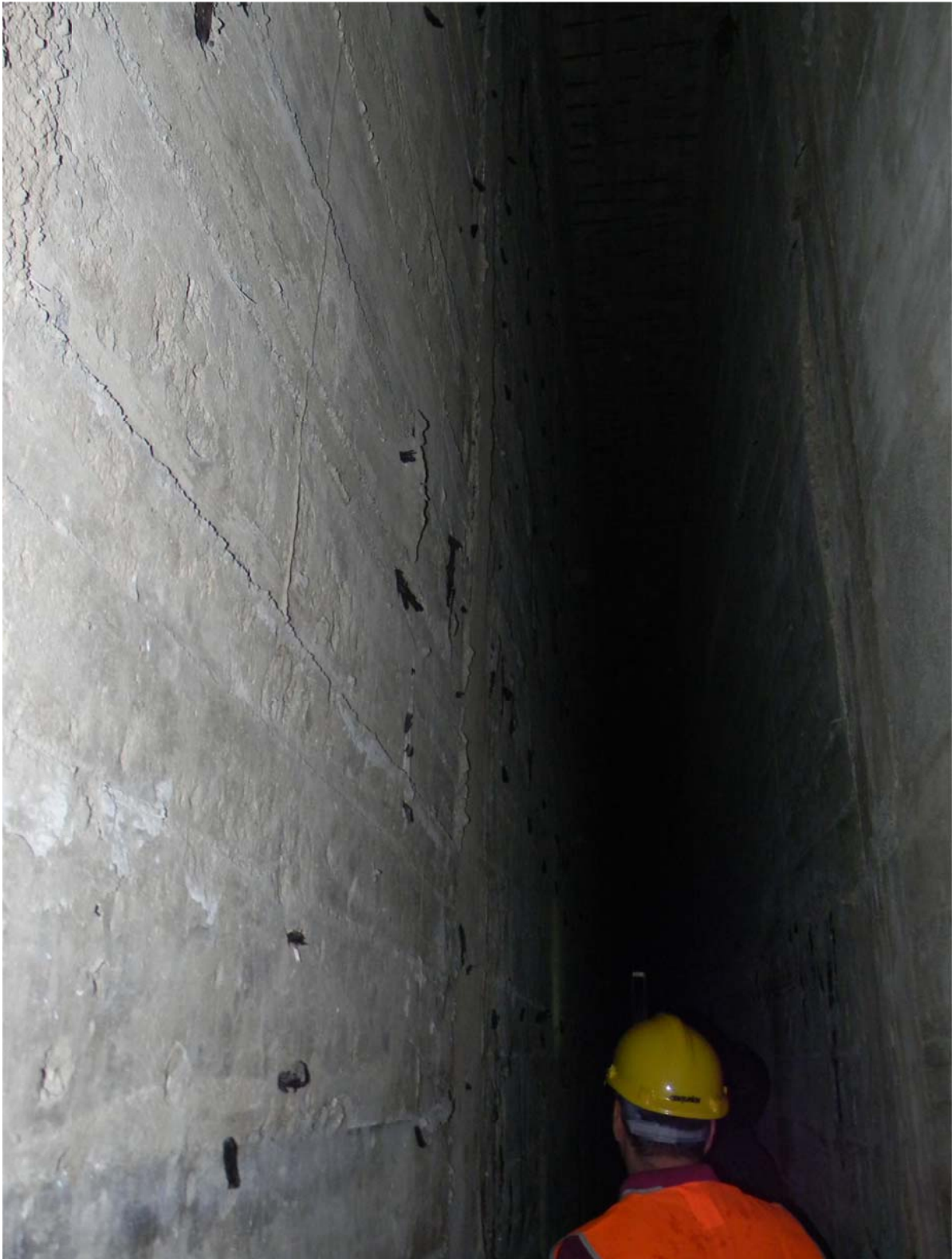
Foto 1 - Cunicoli – Esempio di tratto di parete con livello di degrado di livello “1”
