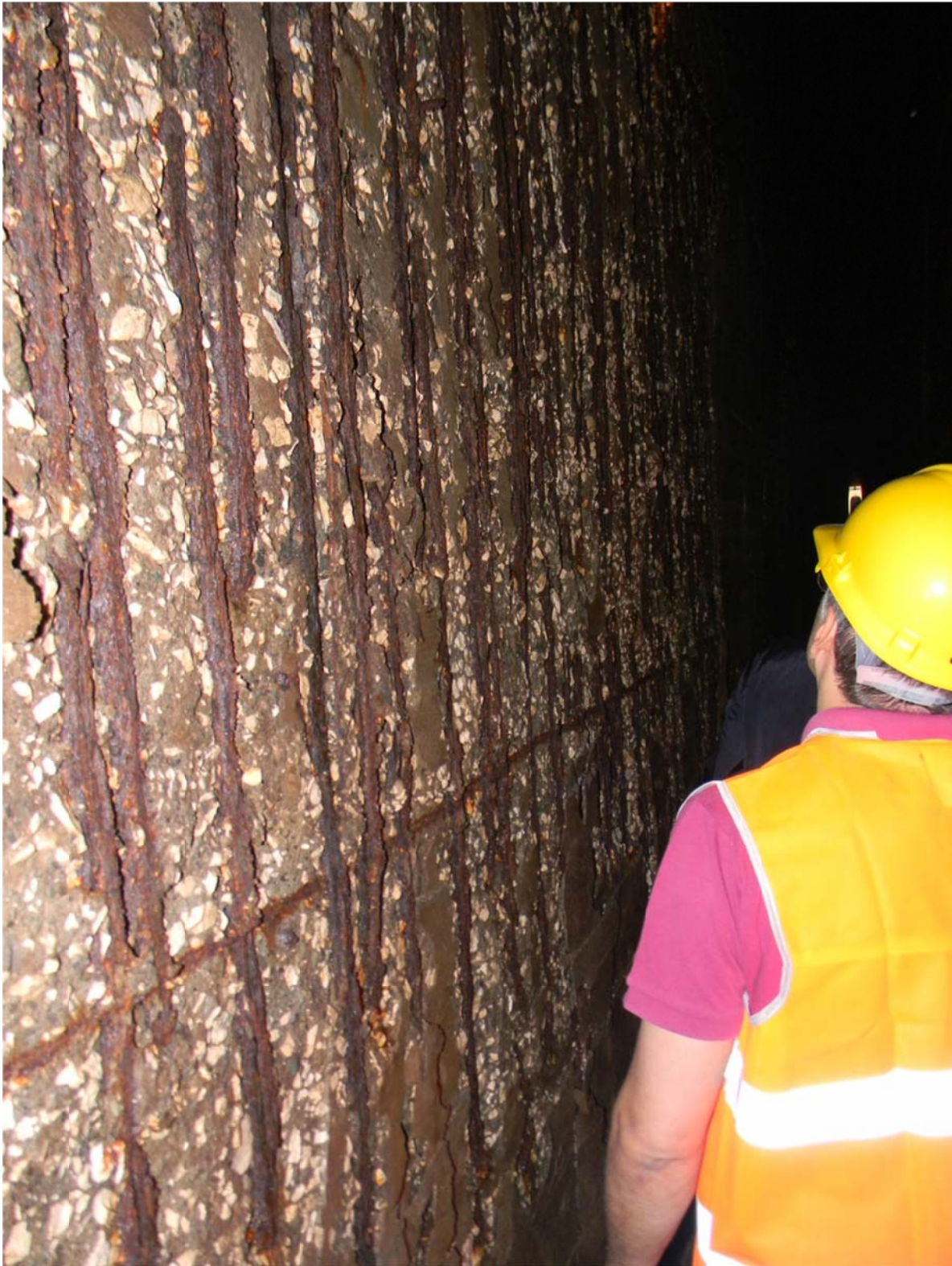
Foto 3 – Cunicoli – Esempio di tratto di parete con livello di degrado di livello “3”
